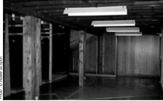
Du trop plein au vide. Au fond à gauche, le caisson isolé par une housse (Polyane).
